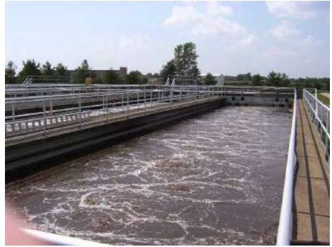
บ่อบำบัดน้ำเสีย
